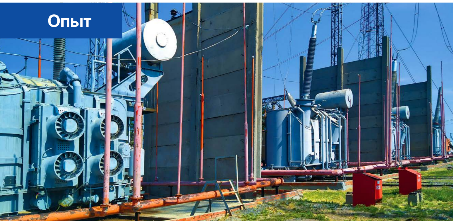
● Проектирование и внедрение комплексных систем мониторинга состояния силовых трансформаторов.
