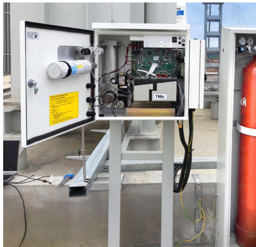
● Многолетний опыт реализации проектов оснащения трансформаторов 110-750 кВ стационарными системами DGA.
