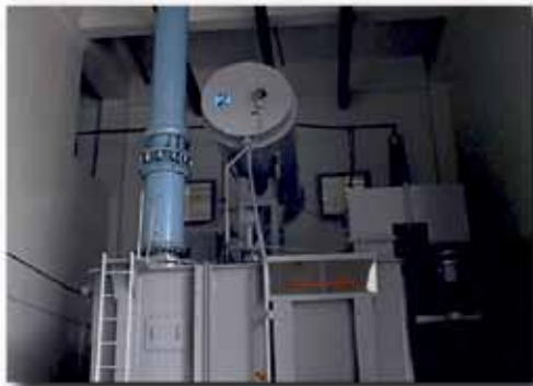
▲ Обнаружена проблема — разрушенное шинное сочлеление
